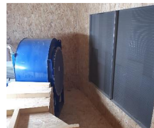
Batterie d'eau chaude
