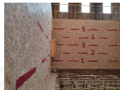
Cellule de séchage avec caillebotis en treillis métallique et parois recouvertes en OSB
