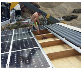
Capteur solaire équipé de panneaux photovoltaïques
