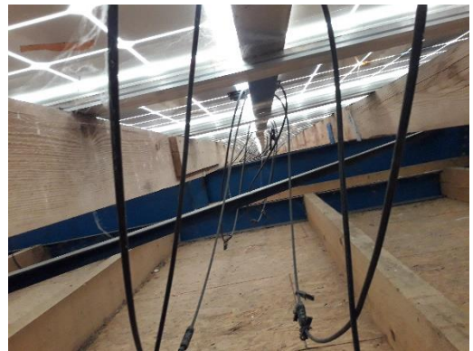
Vue dans le capteur solaire
