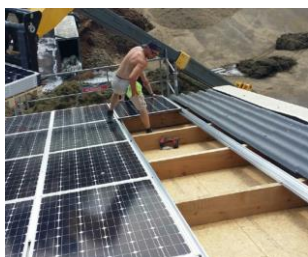
Capteur solaire équipé de panneaux photovoltaïques
