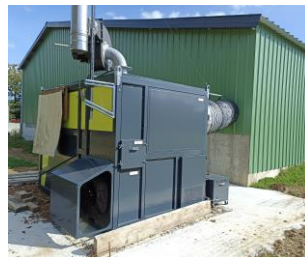
Générateur d'air chaud
