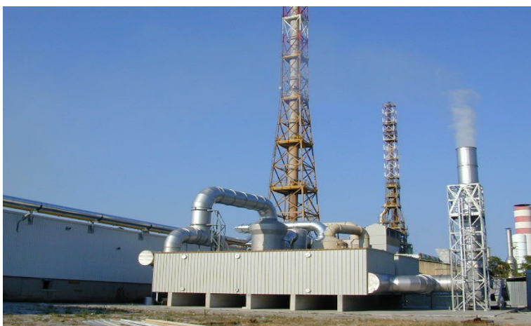
Impianto da 80.000 Nmc/h del 2004 per Vetrotex Saint Gobain Vado Ligure
