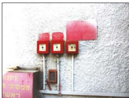
איור 13-3: שורת מפסקי חירום אזוריים בסמיכות יתירה עלולה להטעות את העובדים בשעת חירום
