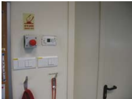
איור 12-3: מפסק חירום אזורי מסומן בשלב
