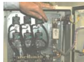
איור 1-10: לוח חשמל מאולתר להספקת חשמל לציוד
