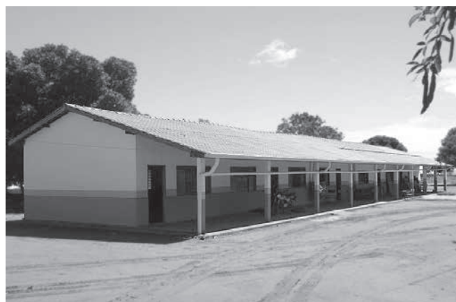
Figura 2 - Telhado com calhas de coleta da água da chuva. Escola do Assentamento Sapiquá, em Cáceres-MT
