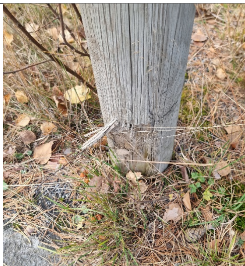
Dårlige stolper i autovernet.
