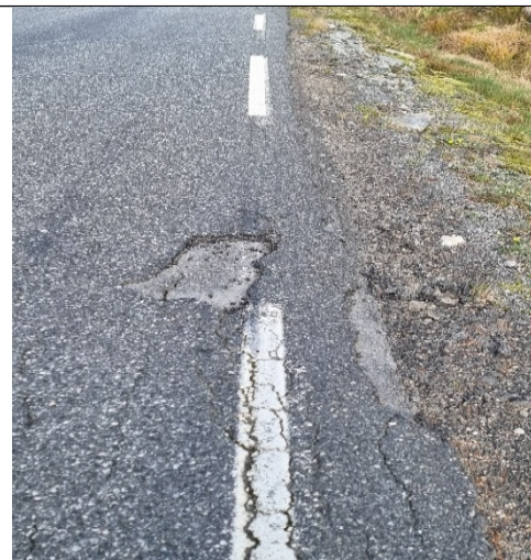
Asfalten på fylkesveien ved Skyttemyr er svært dårlig og veien har også dårlig grunnforhold med store setningsskader. Svært mye anleggstrafikk til Kilandsfoss sliter voldsomt på veien.
