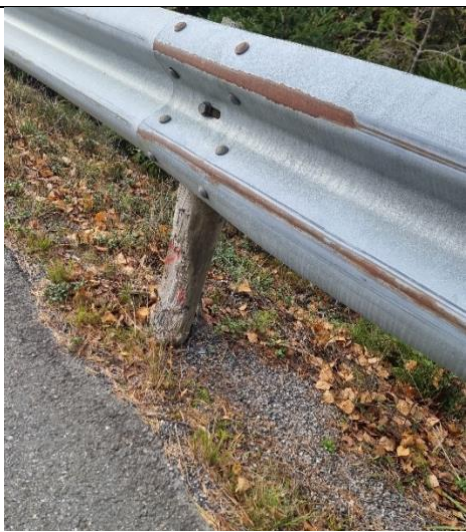
Dårlig autovern ved Kringlemyr.
