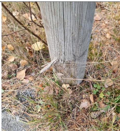
Dårlige stolper i autovernet.
