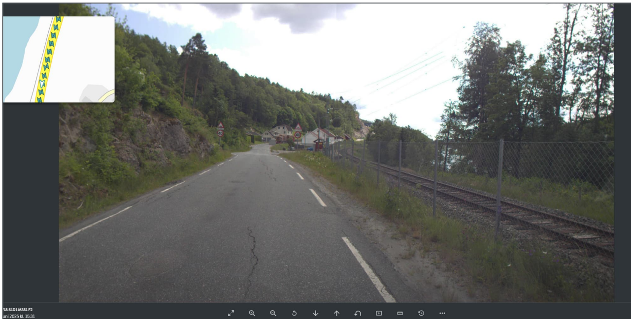
Figur 3-17 Sprekkedannelse i vegbanen. Juni 2025. Vegkart.no.
