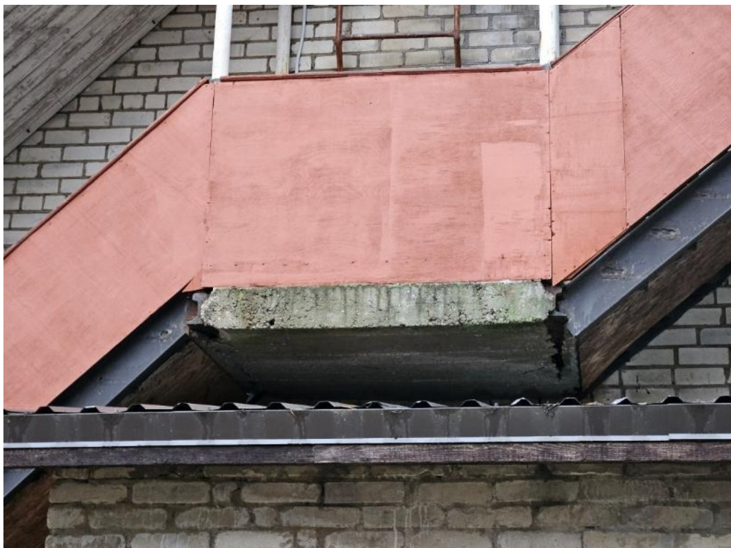
Foto 16. Kolmandale korrusele viiv välitrepp hoone kaguküljel. Hoone soojustamisel on otstarbekas trepp ja vahemade eemaldada.
