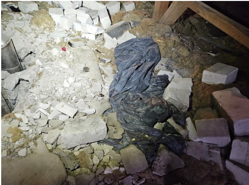
Foto 33. Tõenäoliselt remonttööde järgselt põõningule jäetud ehitusjätmed klaasvillsoojustusmattidel.
