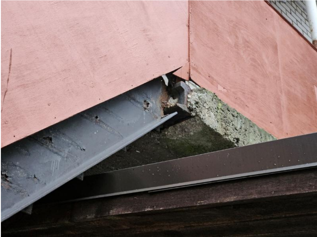
Foto 17. Kolmandale korrusele viiv välitrepp hoone kaguküljel. Näha on läbivat korrosioonikahjustust terasest kandevkonstruktsioonil.
