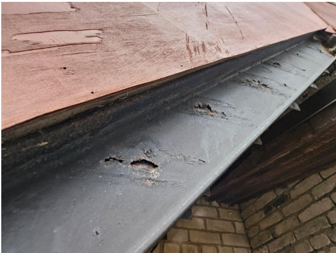
Foto 18. Kolmandale korrusele viiv välitrepp hoone kaguküljel. Näha on läbivat korrosioonikahjustust terasest kandevkonstruktsioonil.
