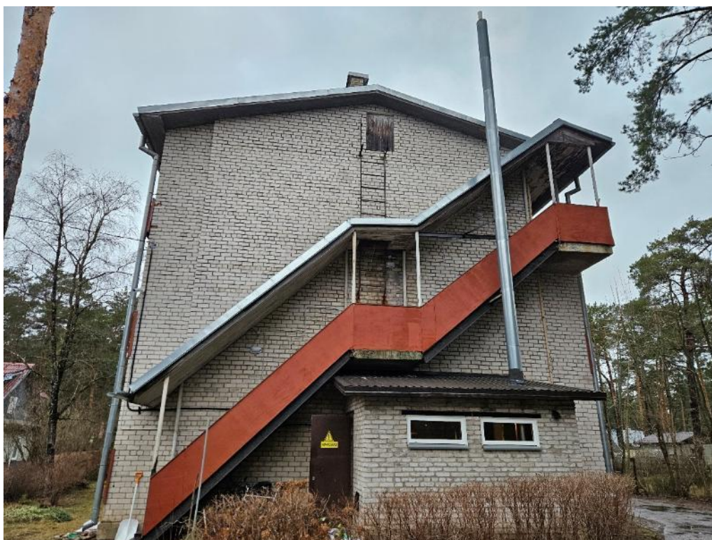
Foto 4. Fassaad kagust. Kaguküljel asuv metalltrepp on mitmel pool läbivalt korrodeerunud, pööningule pääsemiseks kasutatav redel tuleks asenda tänapäevasemaga, mis on seinalle korrektselt kinnitatud. Kaguküljel asub juurdeehitisena katlaruum.
