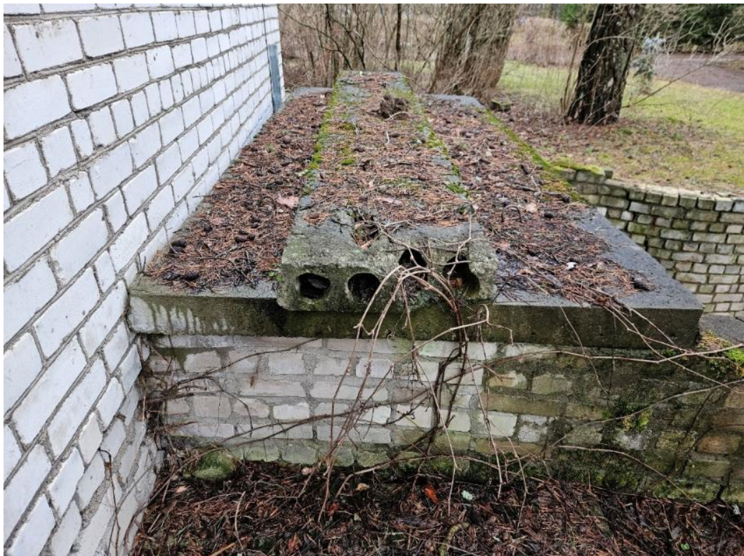
Foto 10. Hoone loodeküljes asuva garaaži sissepääsu juures asuv vahelagi on ilmastikukäes lagunemas.
