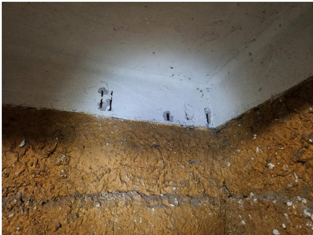
Foto 44. Vaadeldava korteri keldriruumi laes esineb märke vahelaepaneeli terassarruse korrosioonist ja kaitsekihtide irdumisest.
