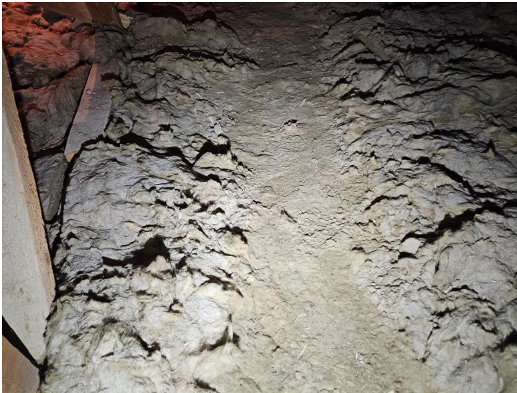
Foto 36. Pööningul on soojustuskihti sisse tallatud käigurajad, mille osas soojusisolatsioon ei ole efektiivne.
