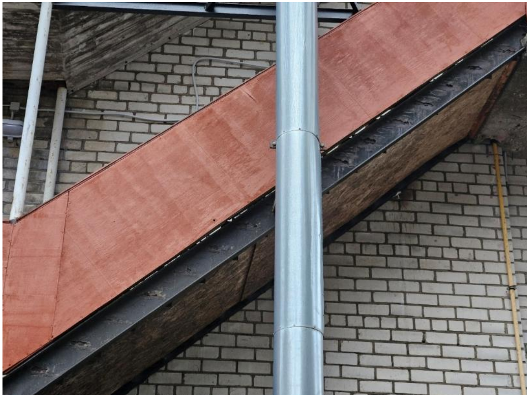
Foto 15. Kolmandale korrusele viiv välitrepp hoone kaguküljel. Näha on läbivat korrosioonikahjustust terasest kandekonstruktsioonil.
