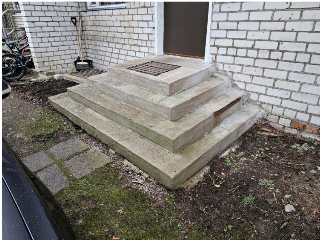
Foto 6. Hoone betoonist välistrepid on osaliselt renoveeritud.
