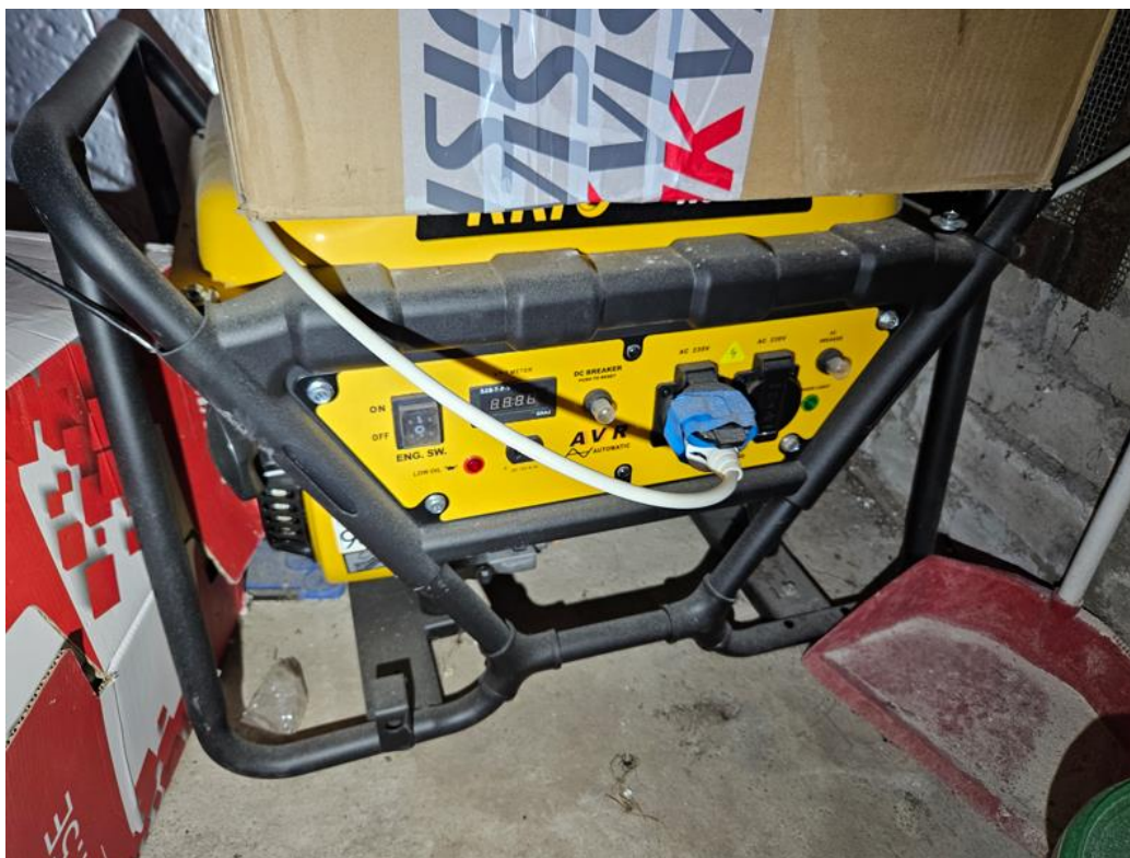
Foto 31. Varutoiteks mõeldud generaator katlaruumis.
