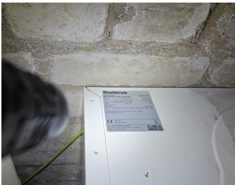
Foto 30. Paikvaatluse ajal oli paigaldatud Buderus 85 kW gaasikatel, mis ei kajastu olemasolevas dokumentatsioonis.
