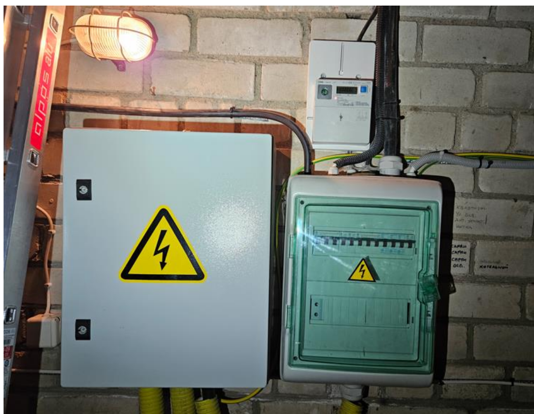
Foto 28. Katlaruumis asuvate elektrikilpide juures puuduvad korrektsed skeemid, tähistused ja dokumentatsioon.
