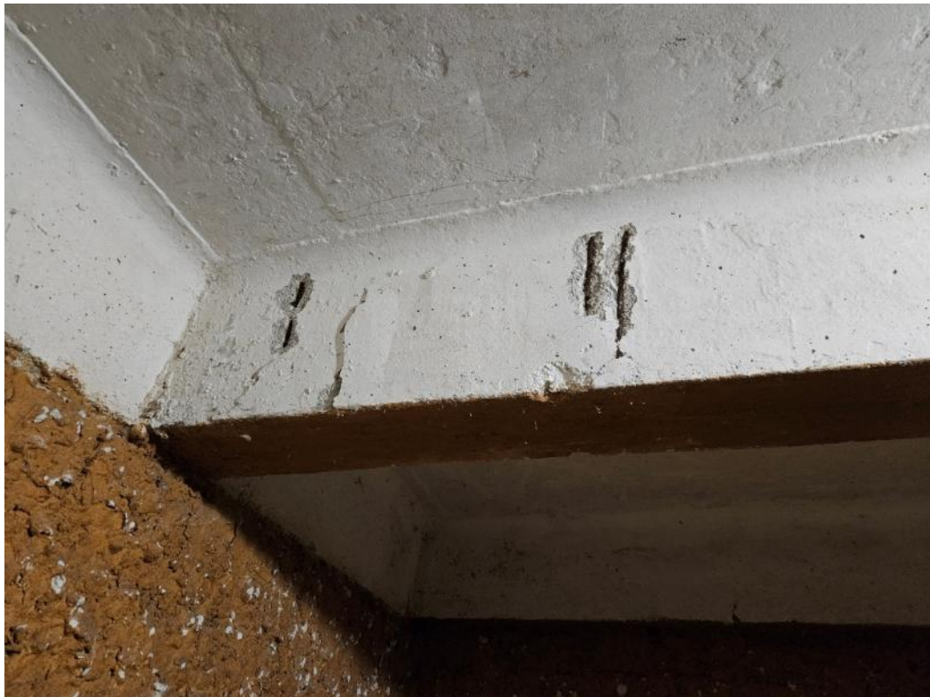
Foto 43. Vaadeldava korteri keldriruumi laes esineb märke vahelaepaneeli terassarruse korrosioonist ja kaitsekihtide irdumisest.
