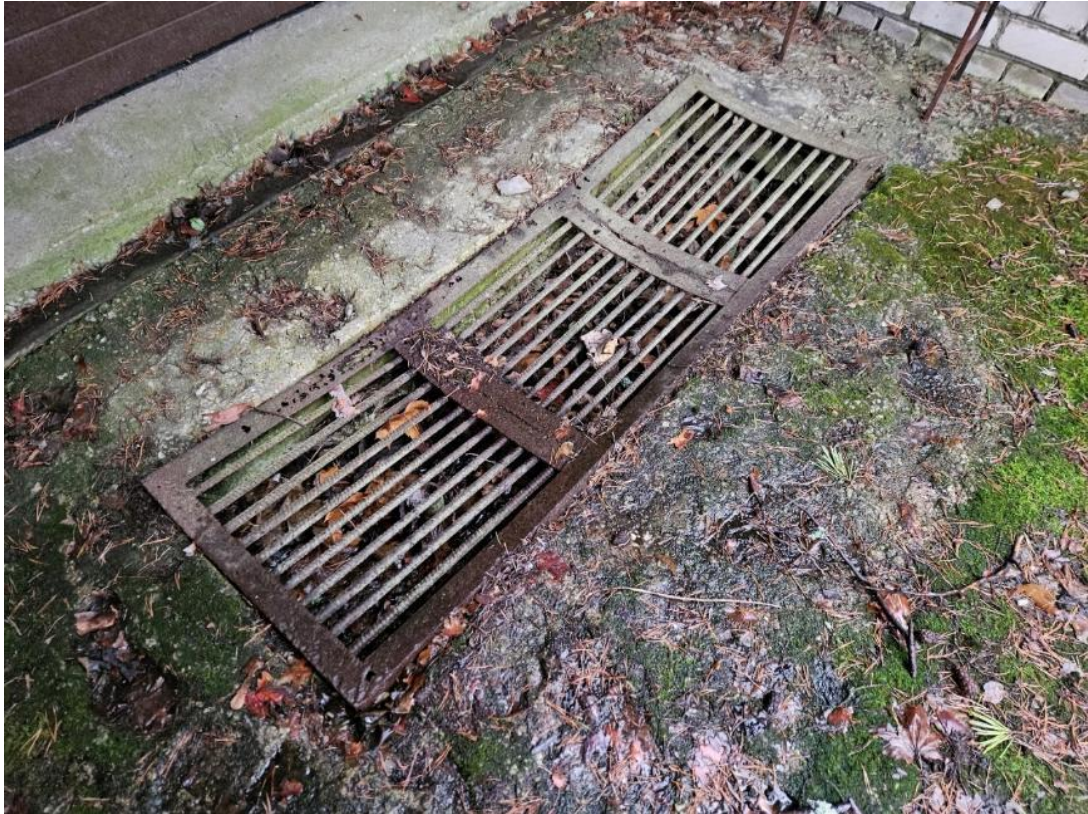
Foto 11. Garaaži sissepääsul asub sadeveerenn on deformeerunud ning hooldamata.
