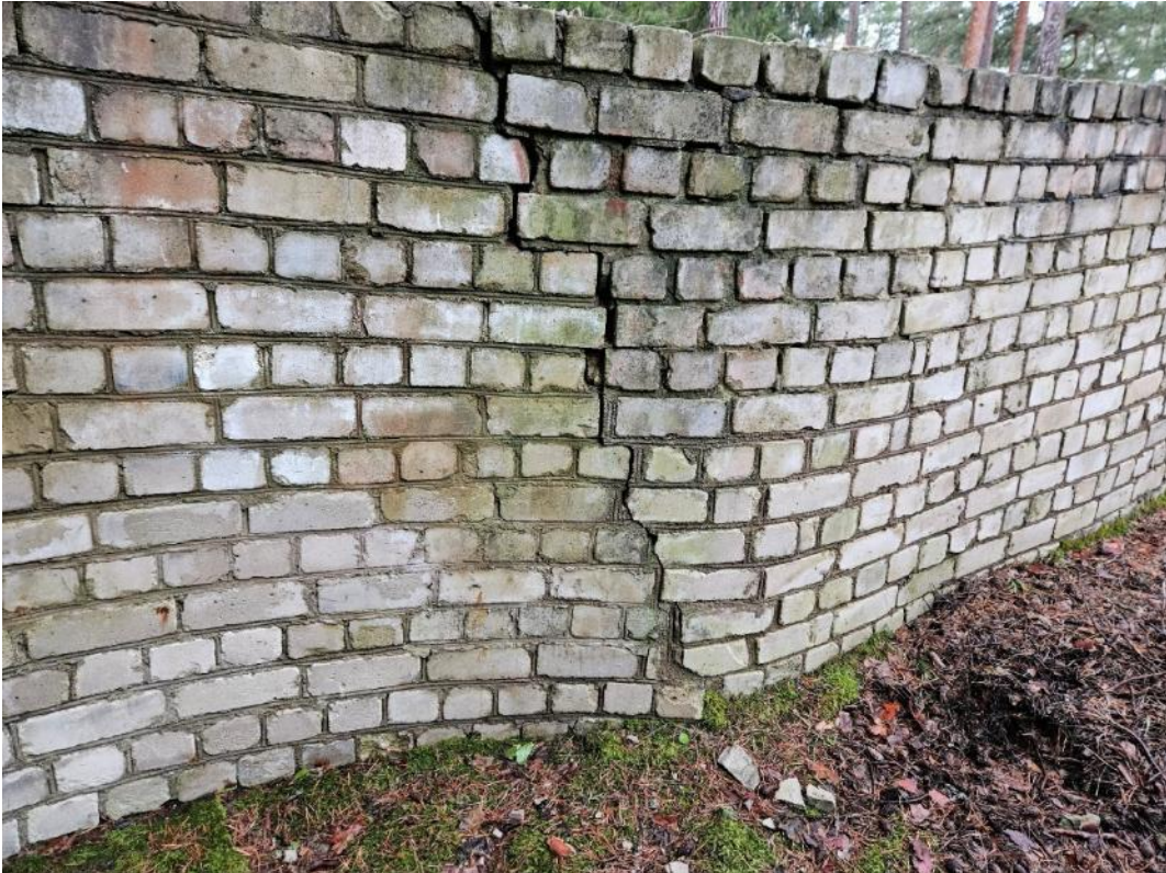
Foto 13. Hoone loodeküljes asuv tugimüür on kohati deformeerunud pinnasesurve toimel ning vajab renoveerimist.
