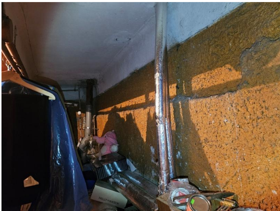
Foto 40. Vaadeldud korteri kelder, kus on näha seinte pragunemist ning torustiku osalist asendamist.
