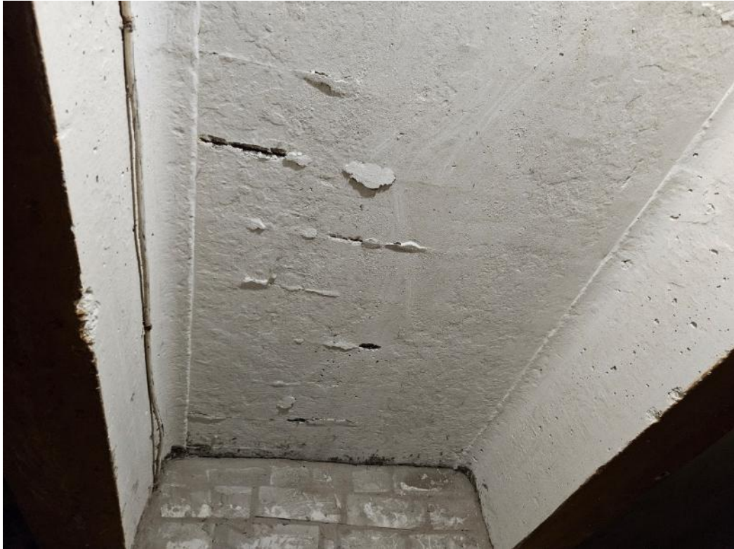
Foto 45. Vaadeldava korteri keldriruumi laes esineb märke vahelaepaneeli terrassarruse korrosioonist ja kaitsekihtide irdumisest.
