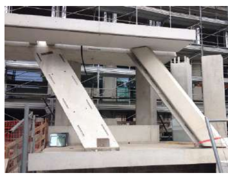
Rivestimento dei pilastri - Fond. Feltrinelli Milano Cladding of the pillars - Fondazione Feltrinelli Milano-Italy
