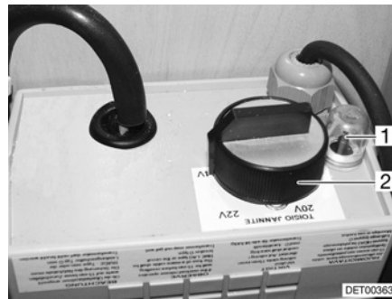
Kuva 89 Sähköisen lattialämmityksen säädin
