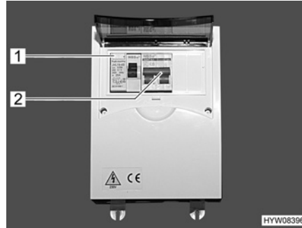
Kuva 79 230 V:n sulakerasia ja johdinsuojakytkin sekä FI-kytkin
