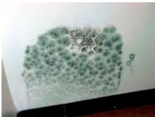
Muggvekst på yttervegg med kuldebro. Foto: Mycoteam
