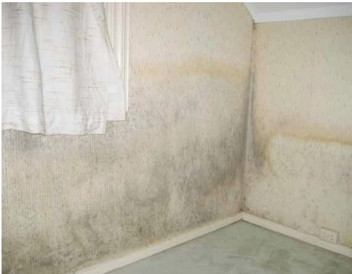
Figur 22. Foto: Kai Gustavsen. Rom uten isolasjon og fuktsperre etter bruk.
