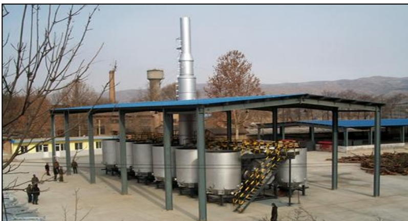
Batterie de 12 fours « CML/LRCB » : collecte/incinération des fumées et défournement à chaud
