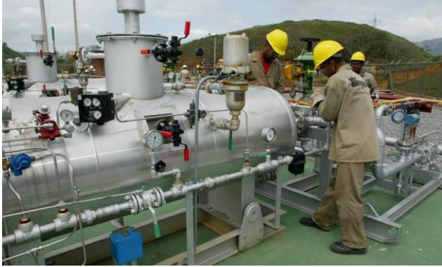
Estação de gás natural em Paracambi, no Estado do Rio — Foto: William de Moura/Agência O Globo
