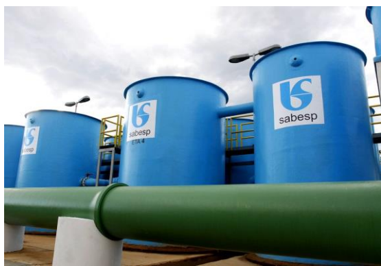
Estação de tratamento de água da Sabesp — Foto: Gilberto Marques/Governo de SP
