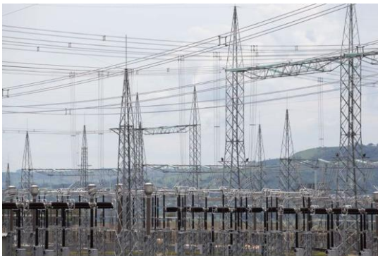
Empreendimento viabiliza o escoamento de energia da região Nordeste. Foto: Agência Brasil
