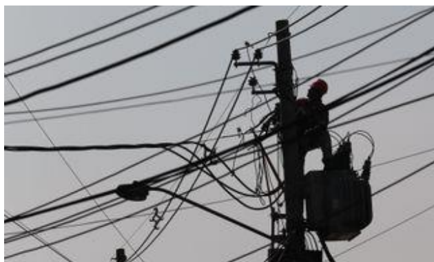
Funcionário da Light trabalha em Jacarepaguá, zona oeste do Rio Foto: Wilton Junior/ Estadão
