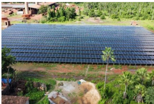
Usina solar da cerâmica Girão & Ramos, com projeto da VS Elétrica e equipamentos Renovigi. Foto: Divulgação
