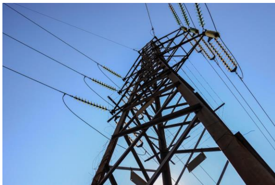
Linhas de transmissão de energia em Belo Horizonte — Foto: Rodney Costa/Zimel Press/Agência O Globo
