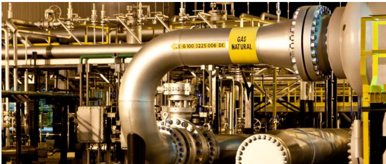
Instalações do Gasbol – Gasoduto Bolívia-Brasil (Foto: Divulgação TBG)
