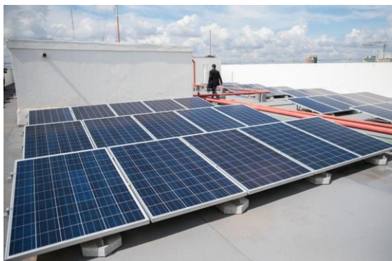
Usina solar instalada na cobertura de um prédio (sede do MME) do governo federal (Foto: José Cruz/Agência Brasil)
