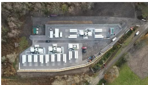
Sistema de armazenamento de energia elétrica Blandford Road da Equinor no Reino Unido (Foto: Divulgação)
