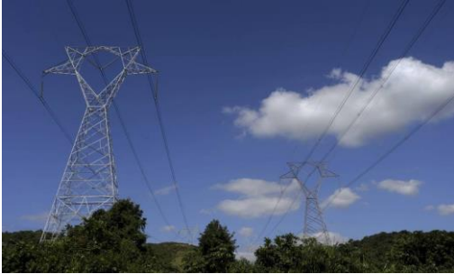
Linhas de transmissão de energia elétrica no Rio — Foto: Arquivo Domingos Peixoto / Agência O Globo
