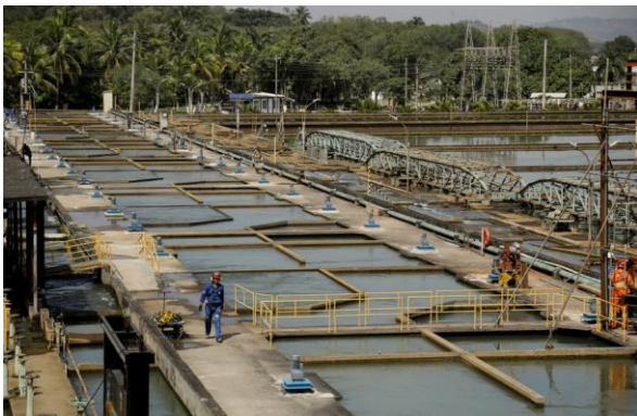
Centro de distribuição de água no Rio — Foto: Gabriel de Paiva
