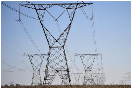
Linha de transmissão da Eletrobras. Foto: FOTO MARCELLO CASAL JR / AGÊNCIA BRASIL
