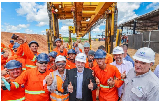
Presidente Lula posa com operários em visita a trecho da ferrovia Transnordestina em Iguatu (CE), no dia 5 de abril de 2024. Foto: Ricardo Stuckert/PR
