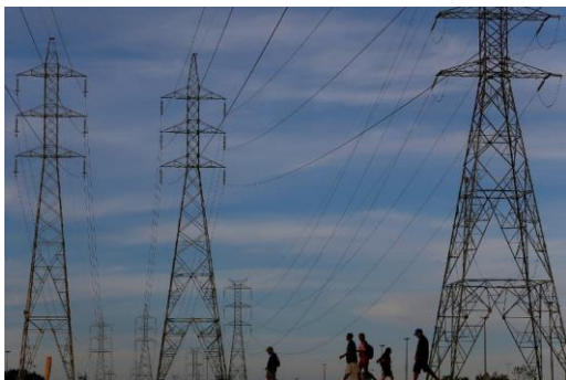
Torres de transmissão de energia — Foto: Agência O Globo
