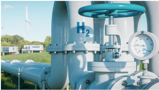
Duto de hidrogênio | Foto Divulgação DNV GL
