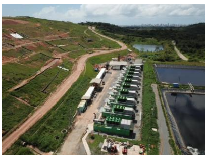
Estação de biogás da térmica de Jaboaão dos Guararapes instalada no Ecoparque da Orizon. Foto: Orizon/Divulgação
