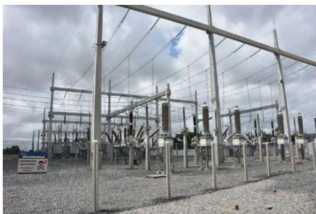
Subestação da Mirueira/foto: Eletrobras
