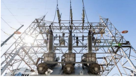
Subestação de energia elétrica | Foto Aldward Castillo/Unsplash
