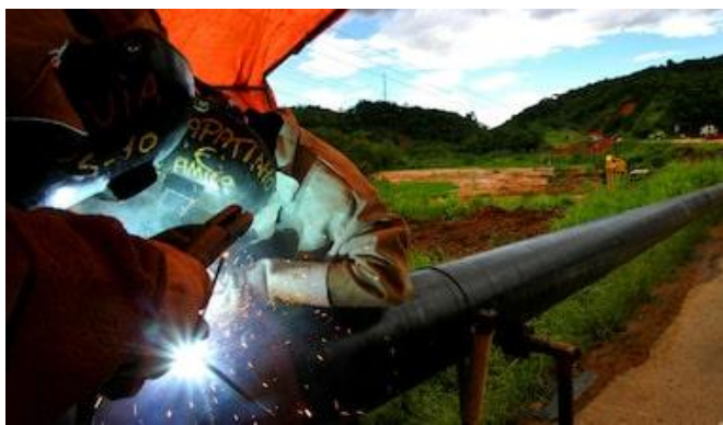
Trecho do gasoduto Bolívia-Brasil em Santa Catarina Foto: Filipe Araújo/Estadão
