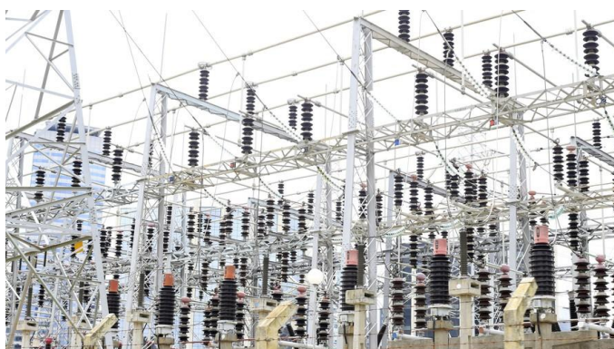
Estação de distribuição de energia elétrica — Foto: Edilson Dantas/Agência O Globo
