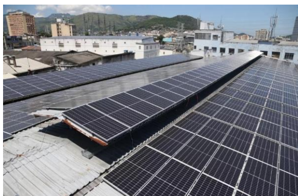
Placas de energia solar em telhado do Rio — Foto: Pedro Teixeira/Agência O Globo
