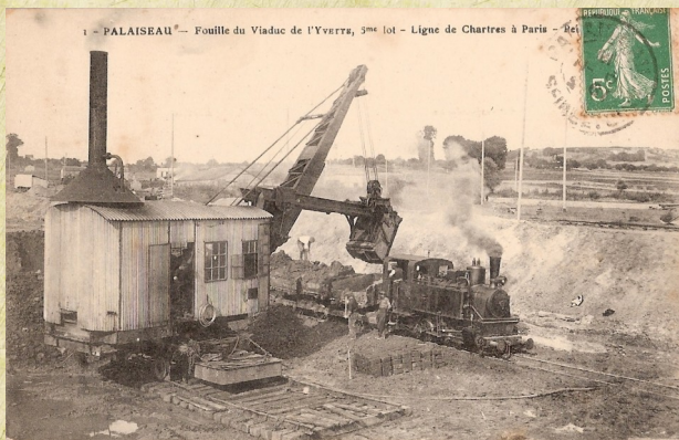
PALAISEAU - Fouille du Viaduc de l'Yvette 5 ème lot - ligne de Chartres à Paris
