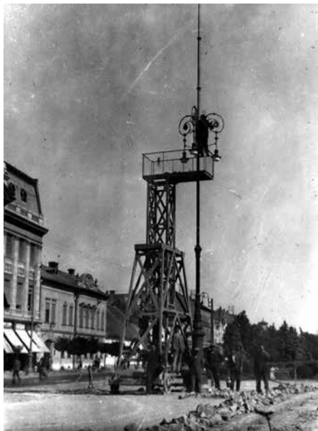
Amplasarea stâlpului pentru iluminat public în fața Primăriei
