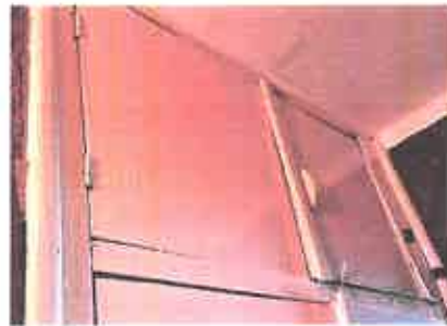
Natynkowe rozwiązania instalacyjne w łazience. Końcówka rury gazowej w kuchni. Oryginalna zabudowa w przedpokoju.
